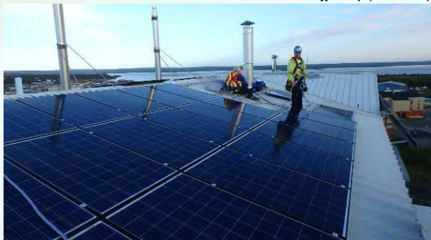
Bâtiments Makivik & Research Center Kuujuaq (70 kW)
