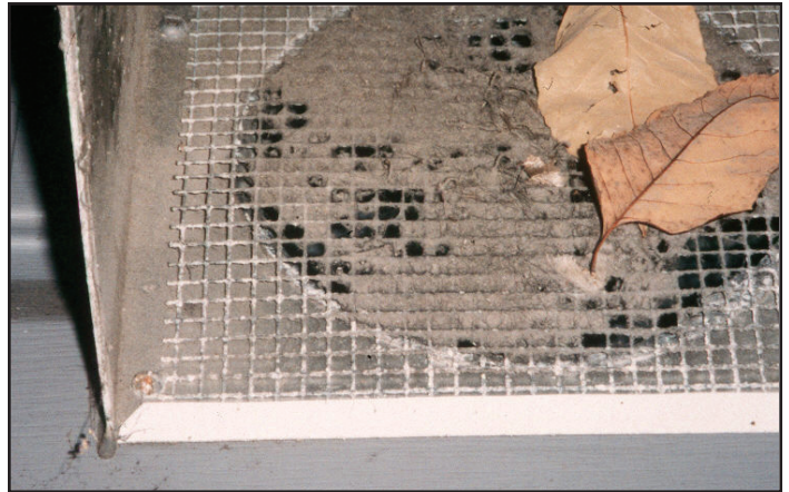
Figure 1 Entrée obstruée du VRC
