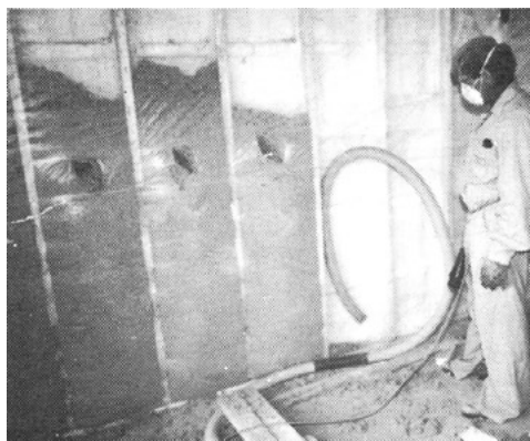
Isolée à l'uréthane et à la cellulose, cette maison de Chambly est la plus étanche jamais testée par Hydro-Québec.
