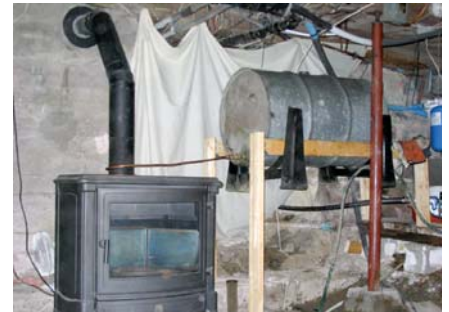
Ce réservoir alimente par gravité le poêle au mazout avec de l'huile végétale récupérée. Une installation illégale, car elle ne satisfait aucune norme pour le chauffage d'appoint.
