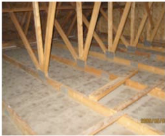
Gypse moisi dans les combles d'une maison non étanche à l'air.
